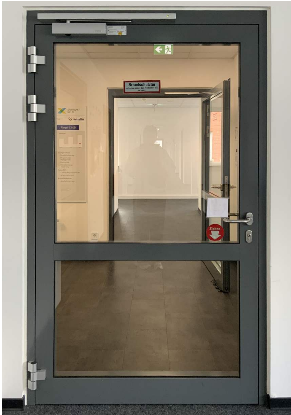
Foto 2: Für die Wiederverwendung identifizierte Brandschutztür bei einem PDA nach DIN SPEC 91484. Concular GmbH.
