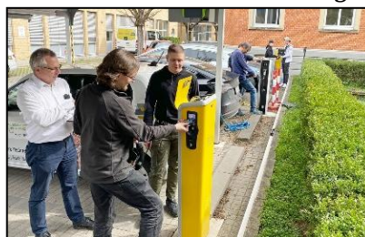
Ladesäulen für Elektromobilität
